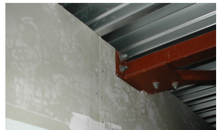
Opening tussen dak en brandwerende wand: geen brandwerende scheiding
