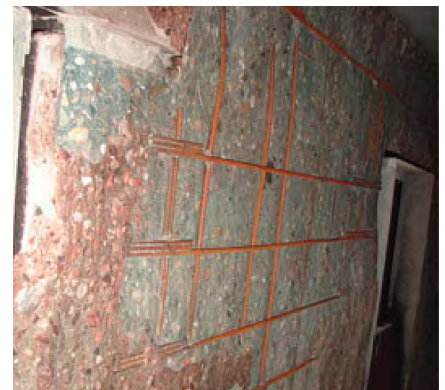
Figuur 3: praktijkvoorbeeld van beton dat van de wapening is afgespat
